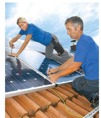
Finden Verbraucher Schäden an ihrer Solaranlage, sollten Fachkräfte die Reparatur übernehmen. Foto: BSW
